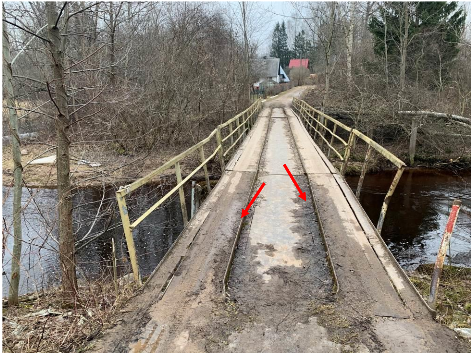
3.att. Tiltā brauktuve izbūvēta ar nepietiekamu platumu b=1.97\text{m} . Vidusdaļā uzstādīti un malās leņķdzelži Skats Ziedu ielas puses.
