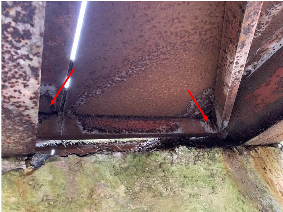
18.att. Stipra sijas korozija balstījuma vietā. Skats virs upes balsta Nr.3.
