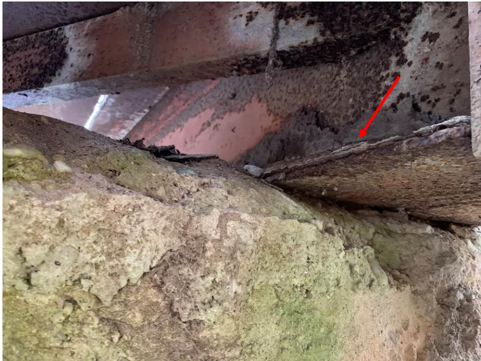
17.att. Stipra sijas korozija balstījuma vietā. Skats virs upes balsta Nr.2.
