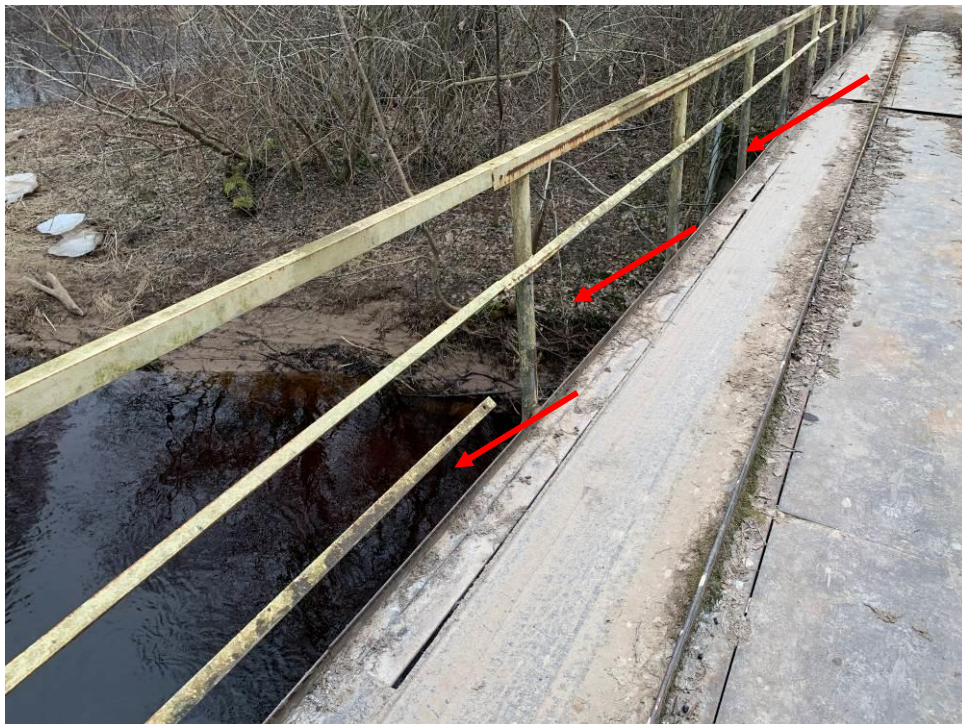
11.att. Trūkst margu aizpildījums, bīstams aizpildījuma gals. Skats 2.laidumā augšteces pusē.
