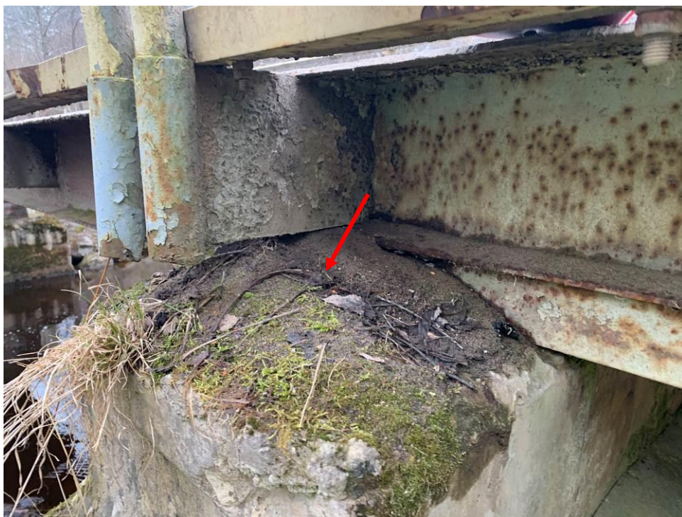
25.att. Sanesumi, nekvalitatīvs betonējums. Skats uz upes balstu Nr.3.
