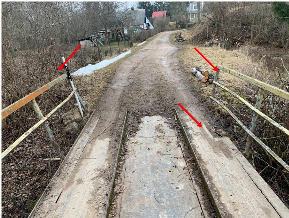
9.att. Tiltā margas vandālisma rezultātā mehāniski atliektas, lai nodrošinātu a/tr caurbraukšanu. Brauktuvē bojājums. Skats uz 3.laidumu.
