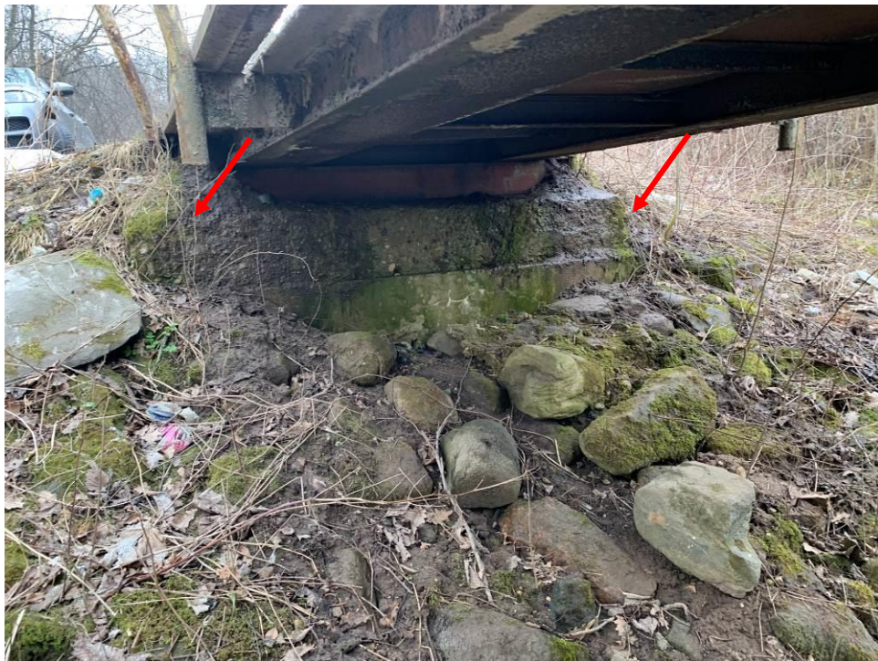
21.att. Sanesumi, nekvalitatīvs betonējums. Skats uz krasta balsta Nr.1.
