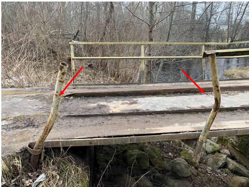
10.att. Mehāniski bojātas un trūkst daļas no margām. Skats 1.laidumā lejteces pusē.
