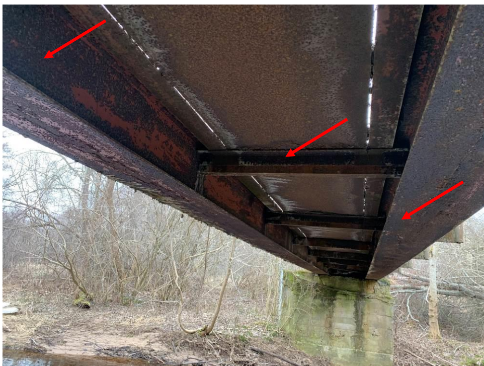
16.att. Vidēja un stipra laiduma konstrukcijas korozija. Vidus daļa nav paredzēta a/tr slodžu uzņemšanai. Skats uz 2.laidumu no apakšas.
