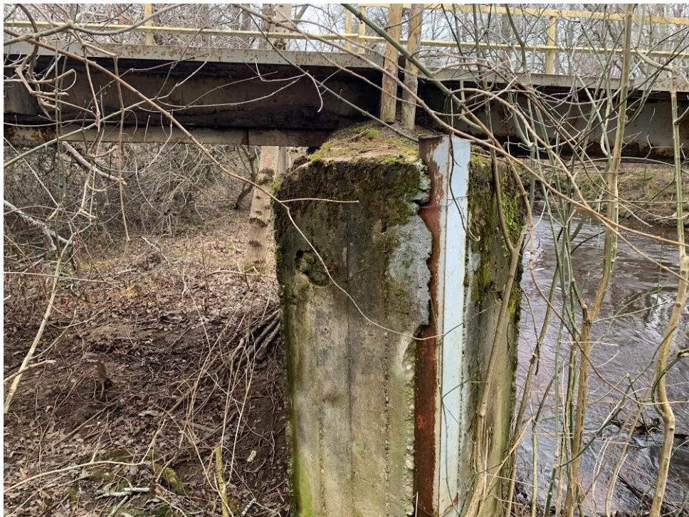
24.att.Sanesumi, nekvalitatīvs betonējums. Skats uz upes balstu Nr.3.
