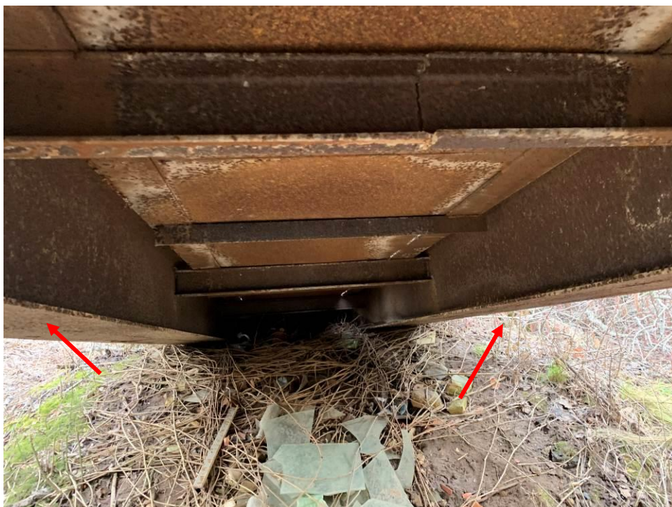
19.att. Vidēja un stipra laiduma konstrukcijas korozija. Vidus daļa nav paredzēta a/tr slodžu uzņemšanai. Skats uz 3.laidumu no apakšas.
