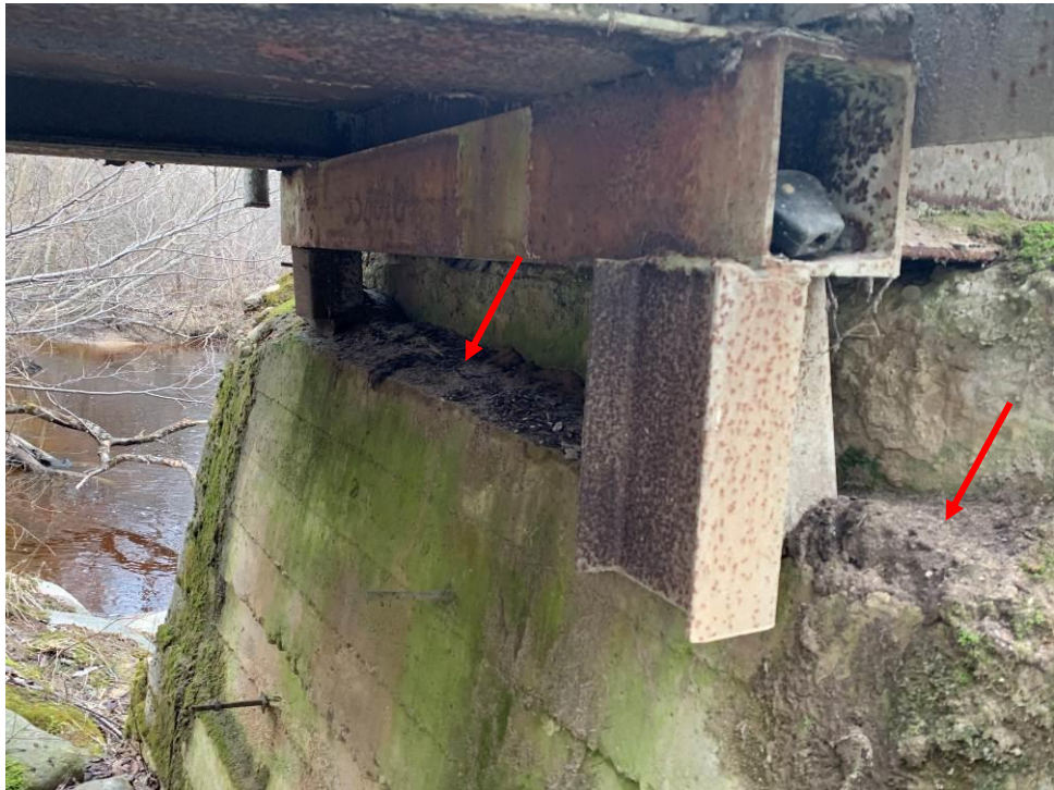
23.att. Sanesumi, nekvalitatīvs betonējums. Skats uz upes balstu Nr.2.
