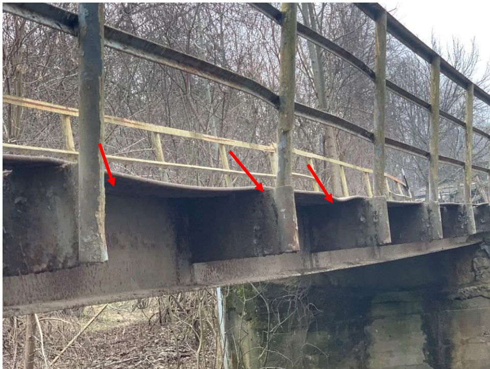
7.att. Autotransporta slodze ietekmē plātnes mala ir deformējusies. Skats 2.laidumā lejteces pusē.
