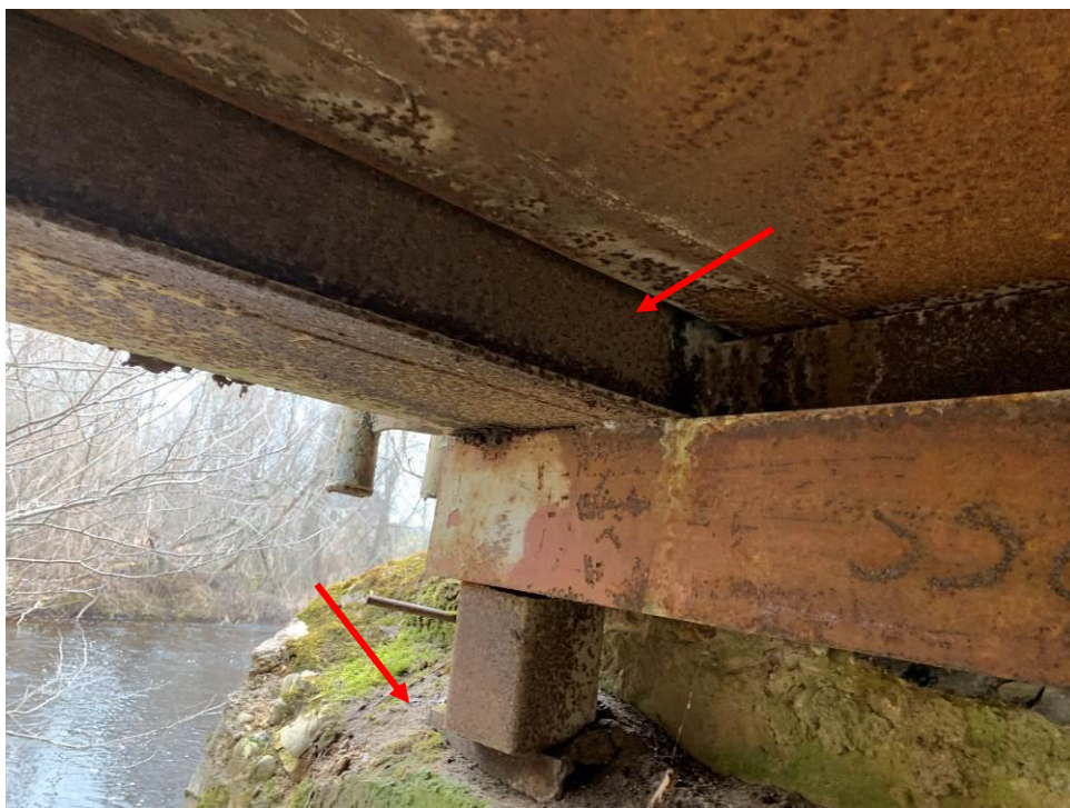
15.att. Vidēja un stipra laiduma konstrukcijas korozija. Balstījuma vieta stāv uz ķīļa. Skats uz 1.laidumu no apakšas augšteces pusē virs upes balsta Nr.2.
