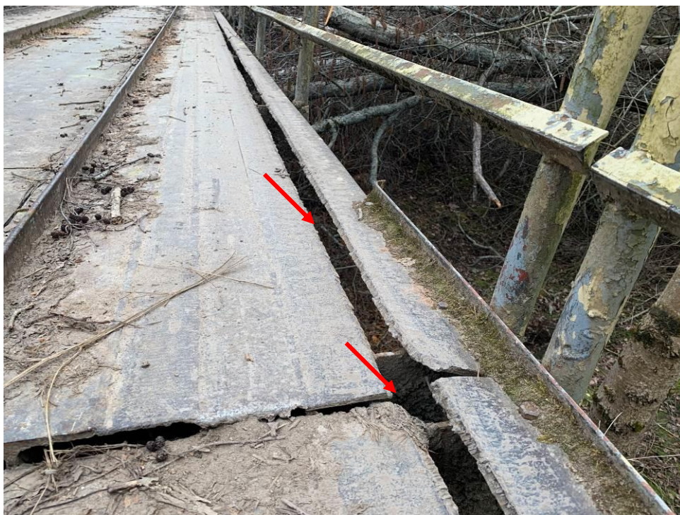
6.att. Brauktuves malas ir nobīdījušās un automašīnas ritenis atrodas uz plānas plāksnes. Skats uz 2.laidumā.
