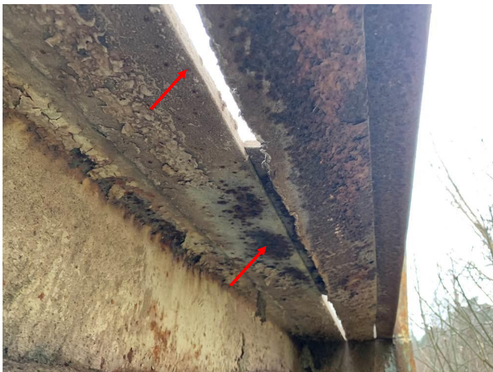
8.att. Autotransporta slodze ietekmē plātnes mala ir deformējusies. Skats uz 2.laiduma konstrukciju no apakšas.
