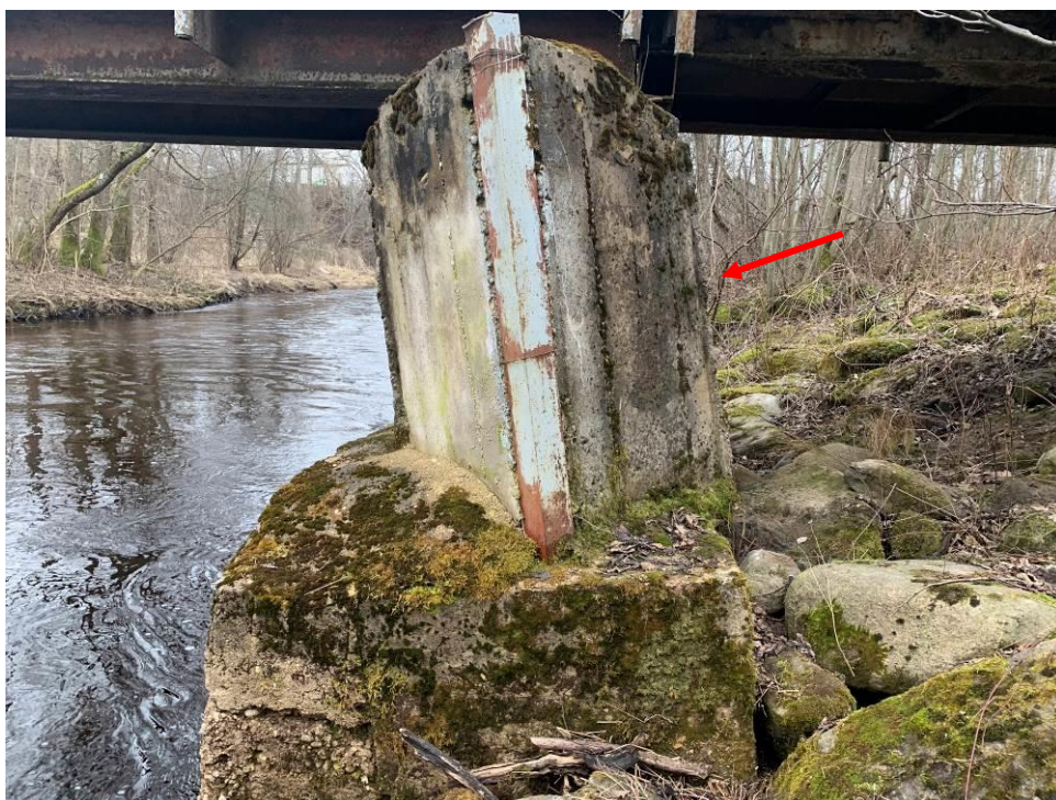
22.att. Sasvērīes upes balsts, nekvalitatīvs betonējums. Skats uz upes balsta Nr.2.
