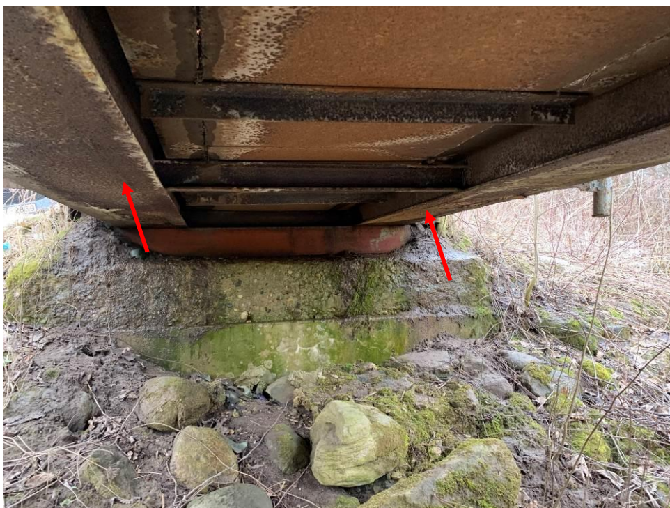
13.att. Vidēja un stipra laiduma konstrukcijas korozija. Vidus daļa nav paredzēta a/tr slodžu uzņemšanai. Skats uz 1.laidumu no apakšas.
