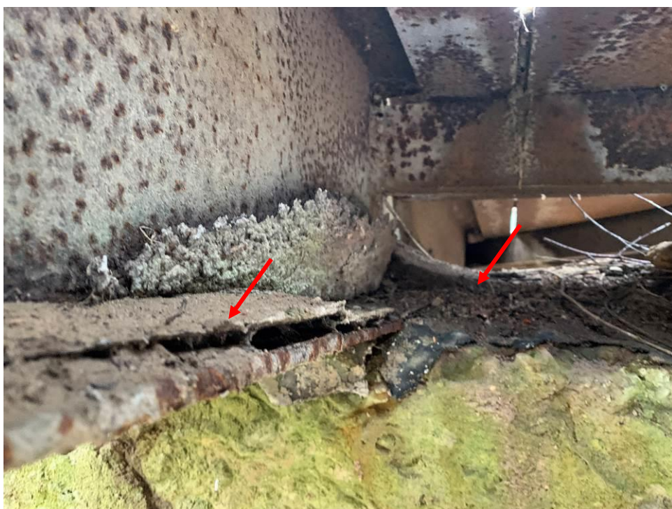
20.att. Stipra sijas korozija balstījuma vietā, sanesumi. Skats virs upes balsta Nr.3.
