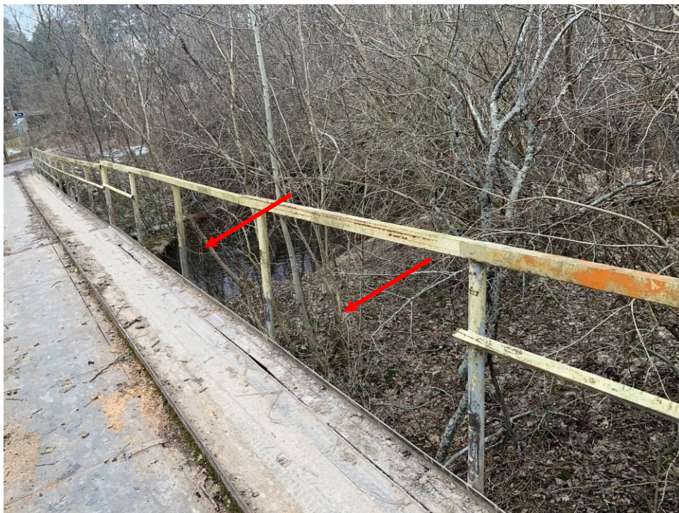
12.att. Trūkst margu aizpildījums, bīstams aizpildījuma gals. Skats 3.laidumā augšteces pusē.
