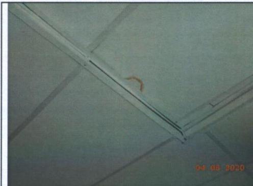
Attēls 4.18.1: tipiski piekārtie griesti – šeit otrajā stāvā redzamas ūdens pēdas
