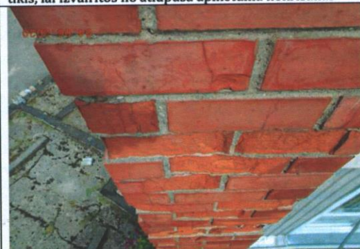
Attēls 4.19.4.: Bojāti sarkanie ķieģeļi ēkas priekšpusē
