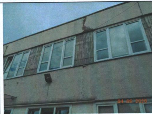
Attēls 4.19.1.: Fasāde ar bojātajām savienojumu vietām
