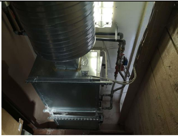
5.6.1 ventilācijas iekārta ēdamzālei
